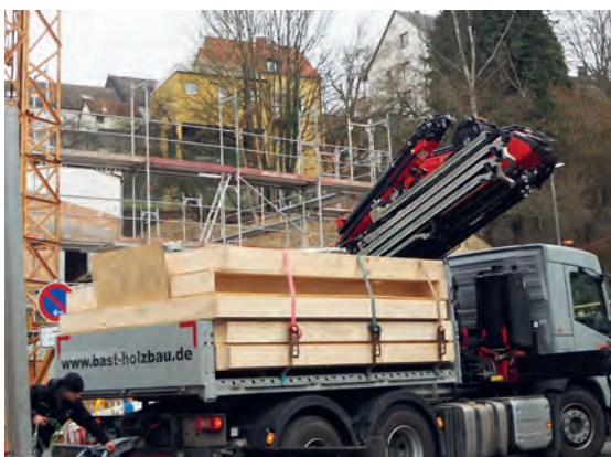
... konnte aufgrund eines defekten Kranes vorerst nicht abgeladen werden.
